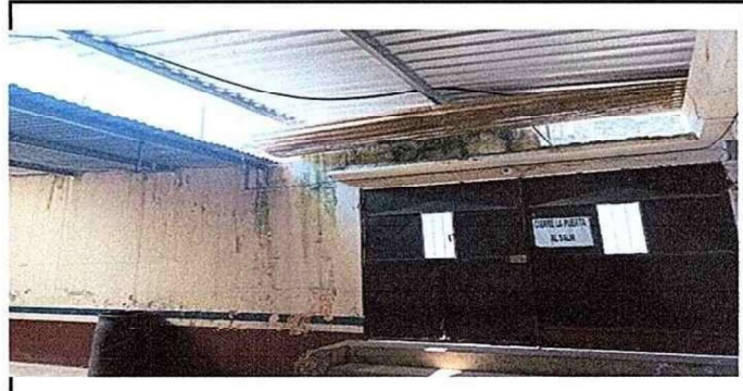
Foto 4: la puerta y el techo en esta entrada están muy deteriorados, el agua se corre directamente hacia el corredor
