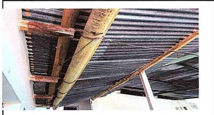
Foto 2: techo en deterioro, los canales en mal estado, entra agua en todos lados
