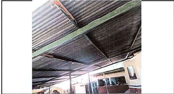
Foto 1: Techo de escenario en deterioro, hay goteros en todas partes y están muy oxidadas las costaneras.
