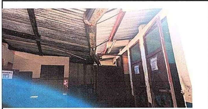
Foto 3: en esta imagen también se observa el techo y los canales en mal estado
