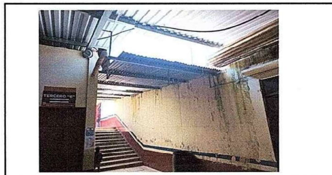
Foto 6: este entechado hay que cambiar, puesto que el agua se derrama en la entrada de las aulas por estar muy bajo.
