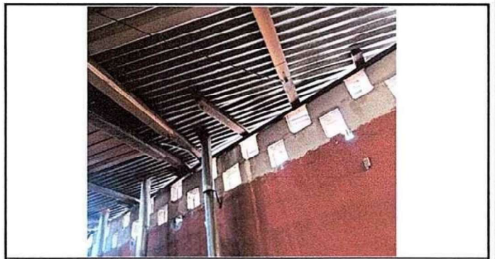
Foto 6: entechado en mal estado
